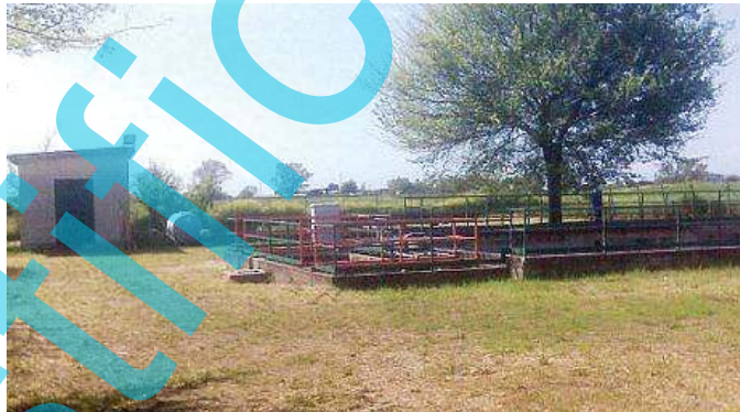
Il depuratore di Albanella
